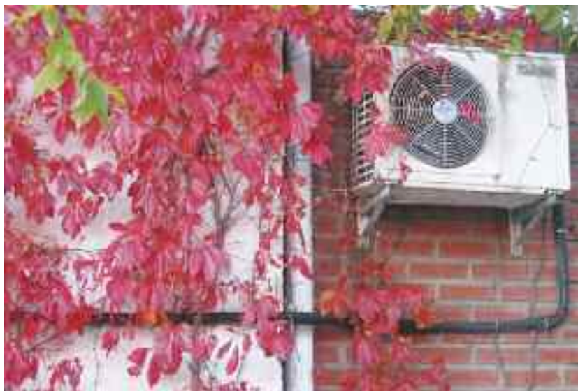
VARMEPUMPER: Luft-til-luft og luft-til-vann er blitt svært populært. Foto: Nina Granlund Sæther.
