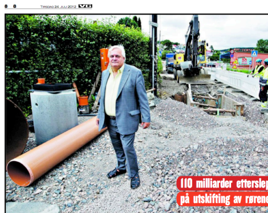
VIL RENOVERE: Huseiernes Landsforbund mener det er på høy tid å fjerne vann- og avløpsnett. Her på byggeplassen ved det nye vann- og avløpsnett på Åsøi i Oslo.
